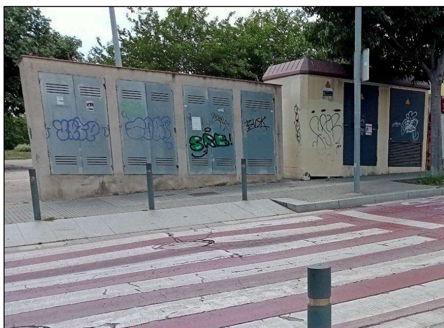
Quadres elèctrics propers a la zona d'actuació
