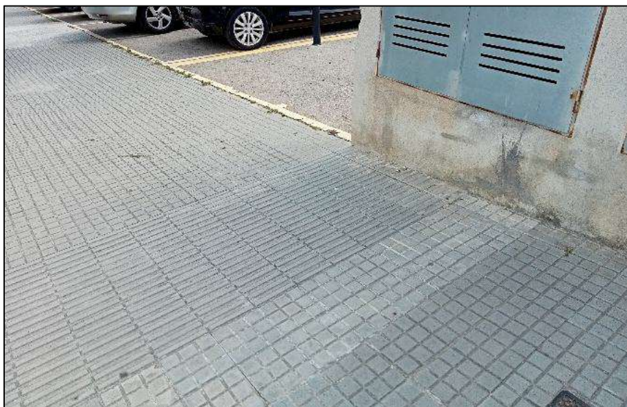
Trobada quadres elèctrics amb vorera
