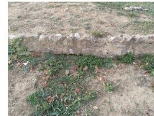
6. Murs perimetrals del Pati on s'observa morter degradat, fongs, falta de material per degradació i elements vegetals.
